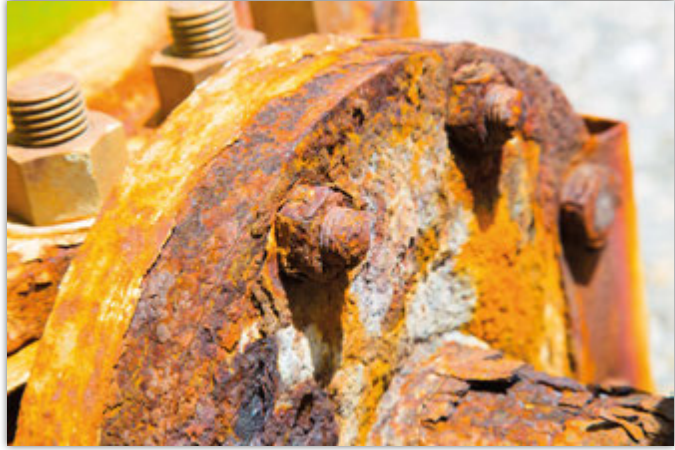
Görsel 2.19: Demirin oksitlenmesi
